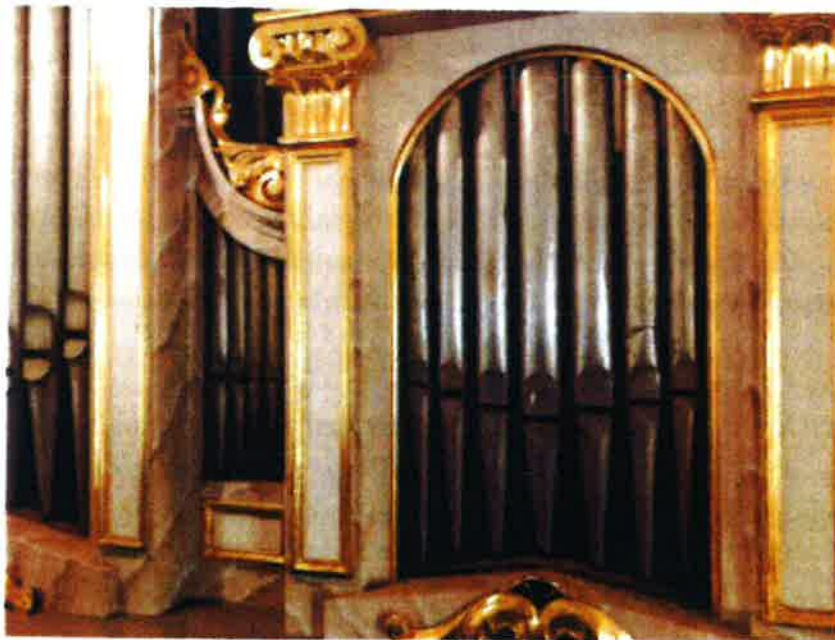
Fot. 10. Stan zachowania piszczałek prospektowych (fragment).
